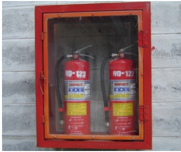
ถังเคมีดับเพลิง
