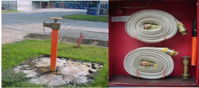
ระบบน้ำดับเพลิง
