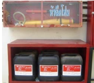
ระบบโฟมดับเพลิง
